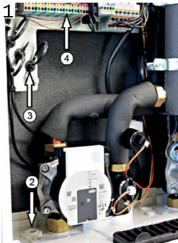
Kabelgeleiding naar klemmenstrook X41
