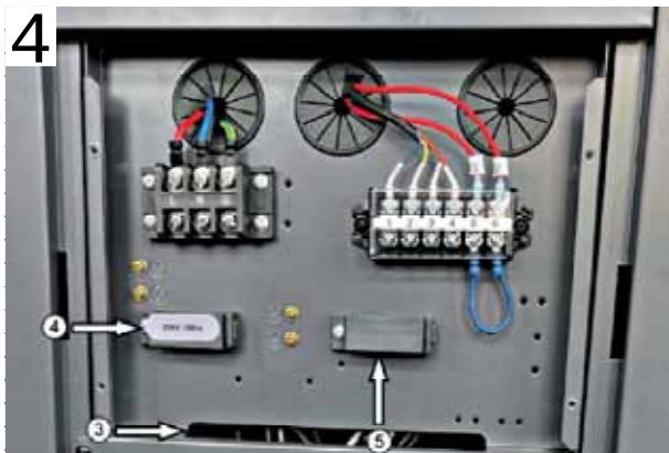
Kabelgeleiding in de buitenunit
